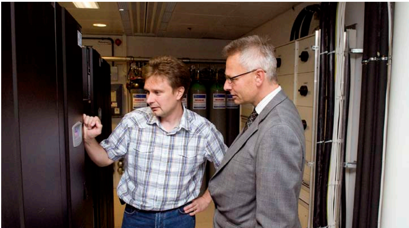
Otaverkon tietoturvapäälikkö Niclas Ek (vas.) ja Teklan tietohallintojohtaja Harald Lundberg tarkastavat UPS-laitteiden tilaa Otaverkon palvelinsalissa Espoossa.
