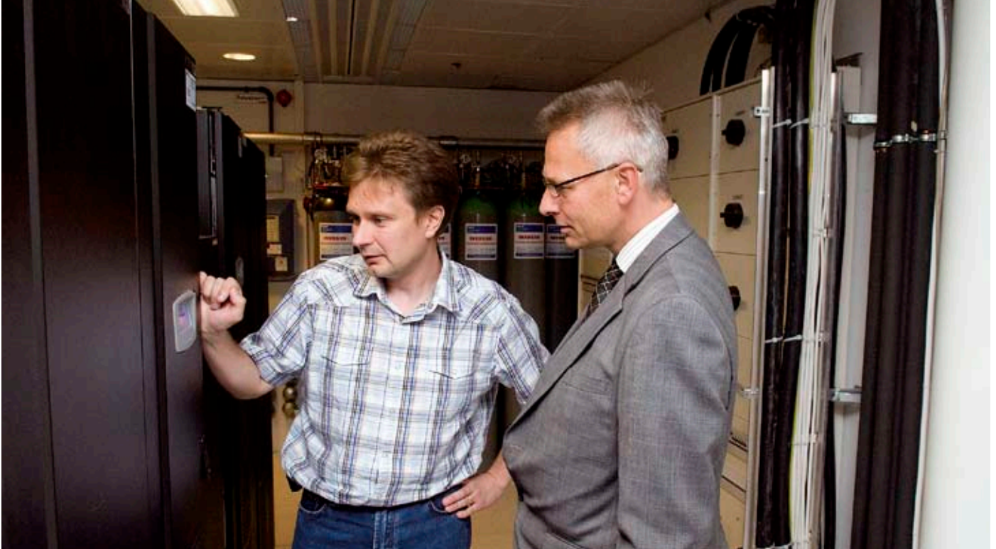
Otaverkon tietoturvapääällikkö Niclas Ek (vas.) ja Teklan tietohallintojohtaja Harald Lundberg tarkastavat UPS-laitteiden tilaa Otaverkon palvelinsalissa Espoossa.
